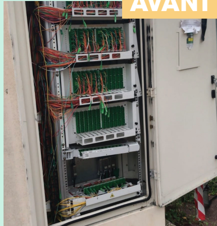
Les armoires fibre fermées et sécurisées
